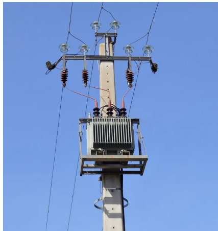
Fig. 2. – Transformateur source sur un poteau Enedis.
