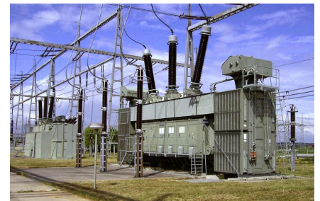
Fig. 3. – Transformateur dans un poste source.
