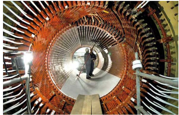
Fig. 3. – Stator d'un alternateur de centrale nucléaire.
